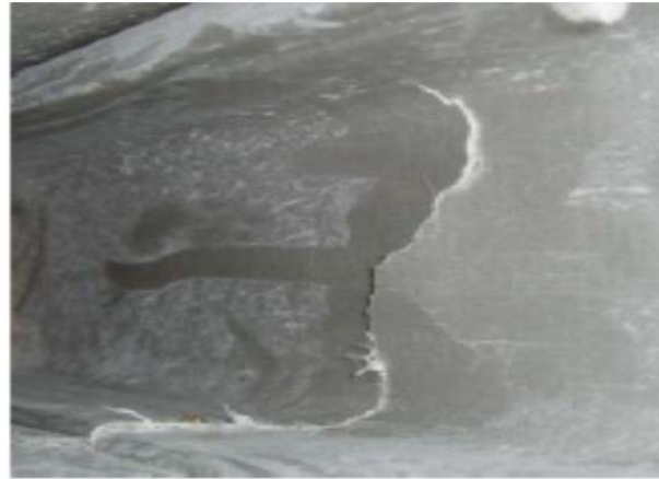
Web Buckling (ZellComp Deck)
